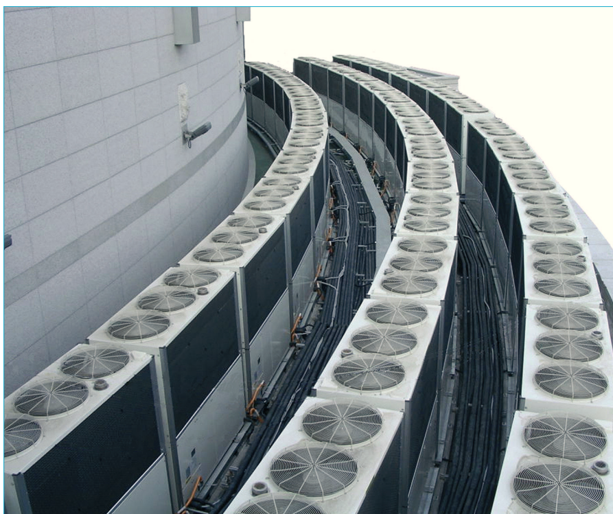
Rys. 1. Jedna z największych instalacji gazowych pomp ciepła na świecie – około 3,3 MW mocy chłodniczej i 3,8 MW mocy grzewczej – zainstalowana na jednym z obiektów w Korei Południowej
