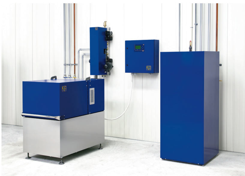
Rys. 2. Zestaw gazowej mikrokogeneracji MCHP XRGI - (od lewej: jednostka kogeneracyjna, dystrybutor ciepła, skrzynka przyłączeniowa z panelem sterowania, zbiornik magazynujący ciepło) [5]
