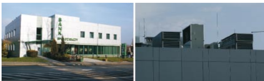
Rys. 12. Instalacja GHP AISIN w Banku Spółdzielczym w Skoczowie. Układ GHP AWS, 45 kW
