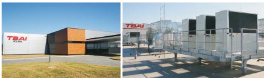
Rys. 14. Instalacja GHP AISIN w fabryce TBAI koło Bolesławca. Układ GHP Dx/AHU, 220 kW
