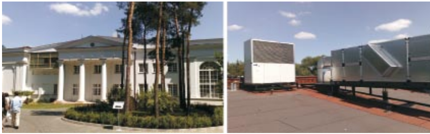
Rys. 15. Instalacja GHP AISIN w centrum konferencyjnym w Warszawie. Układ GHP AWS, 71 kW
